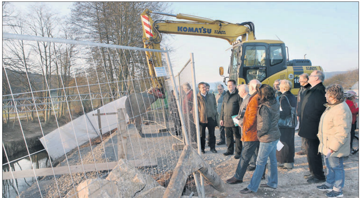
Eine heikle Stelle für die Bürgerinitiative: Die Brücke am Heuweg. Der Ersatz der kürzlich wegen Baufälligkeit abgerissenen Brücke würde im Falle einer Wieslaufverlagerung nach Westen gleich wieder überflüssig. Die Mitglieder der Bürgerinitiative zeigten Claus Paal auch diesen Punkt. Bild: Schneider
