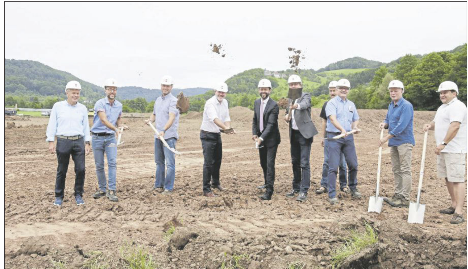
Spatenstich: Bürgermeister Martin Kaufmann (4. von links) neben Dr. Peter Zaar und Diplom-Ingenieur Rüdiger Koch (3. von rechts).
